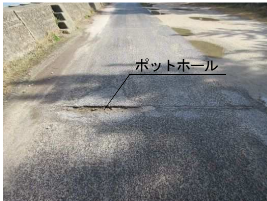
図Ⅱ-23 海岸管理道アスファルト舗装（劣化）
