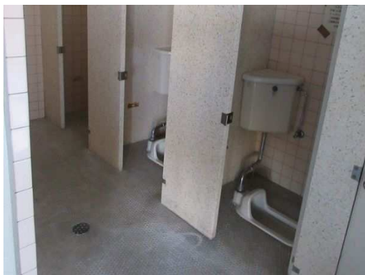
図Ⅲ-6 公衆トイレ（洋式化が必要）
