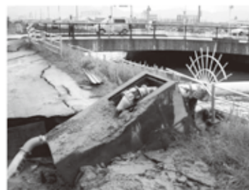
地震の影響で破損した水道管
